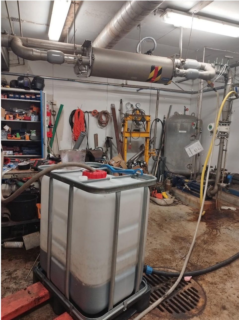
Kuva 8. Ultraäänilaitteisto Virtain jätevedenpuhdistamolla. Edessä alhaalla Huittisten puhdistamolta tuotu palautuslietekonkti ja yläpuolella varoitusteipein merkitty ultraäänilaitte. Kuva: Julia Pihlavisto-Hakala.
